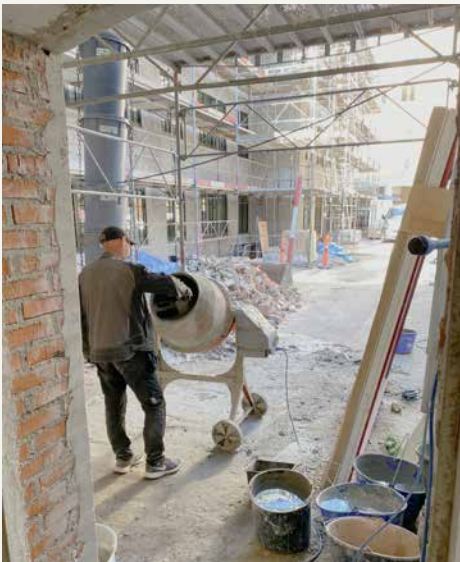
Manglende sikkerhedssko og generelt dårligt arbejdsmiljø
